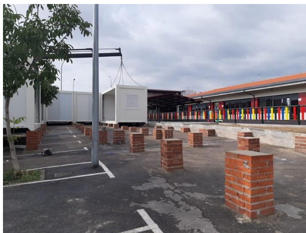
El CEIP “Héroes 2 de Mayo” lleva 5 años abierto y aún está sin terminar. Esto provoca la instalación de barracones para poder garantizar la separación entre alumnos.
